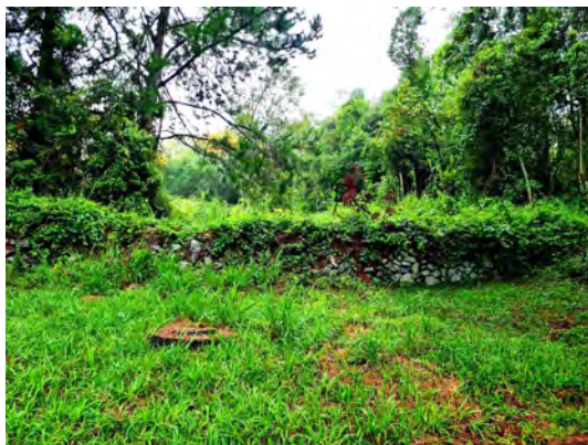
Ruína do muro em pedra seca, avenida dos Lagos | imagem Morais, 2026.
